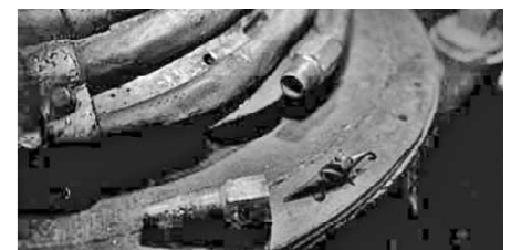
Düse am Rohrende von Schaubbergers "Hausgenerator".
