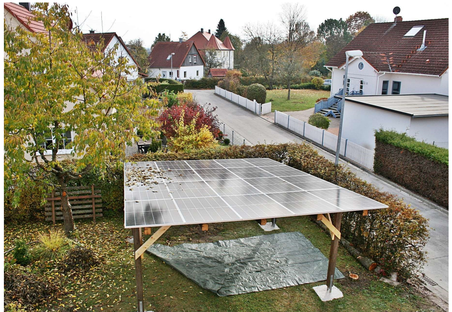
Photovoltaik-Modulfeld als Carport-Dach bestehend aus 20 PV-Modulen à 370 Wp, insgesamt 7'400 Wp.
